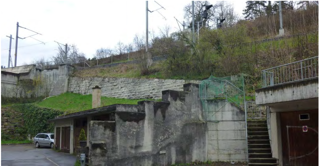
Abbildung 5.7-1: Bahnböschung beim Südportal.
